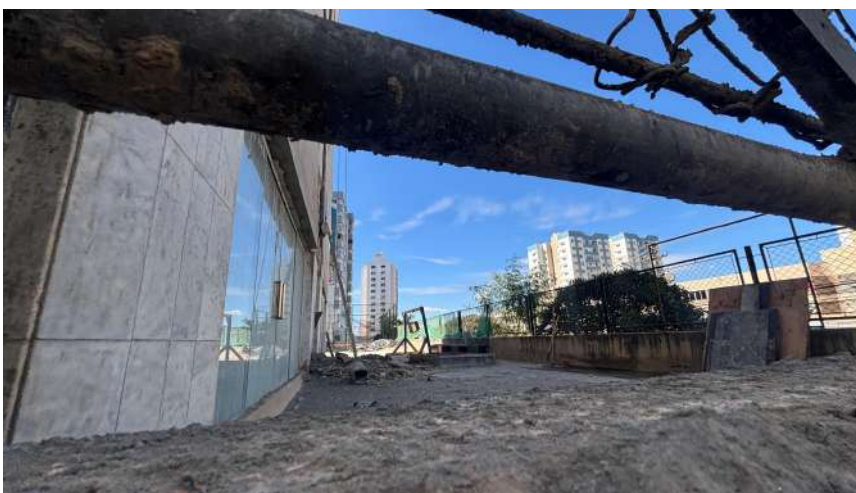
Figura 17- Pavimento irregular. Fonte: Acervo pessoal
