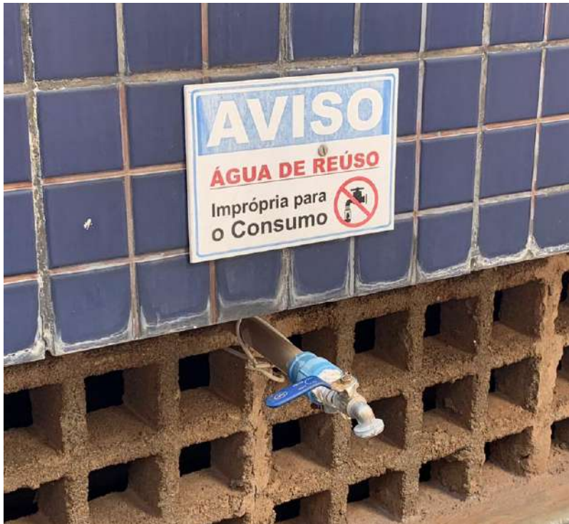
Figura 23-Torneira de serviço. Fonte: Acervo pessoal
