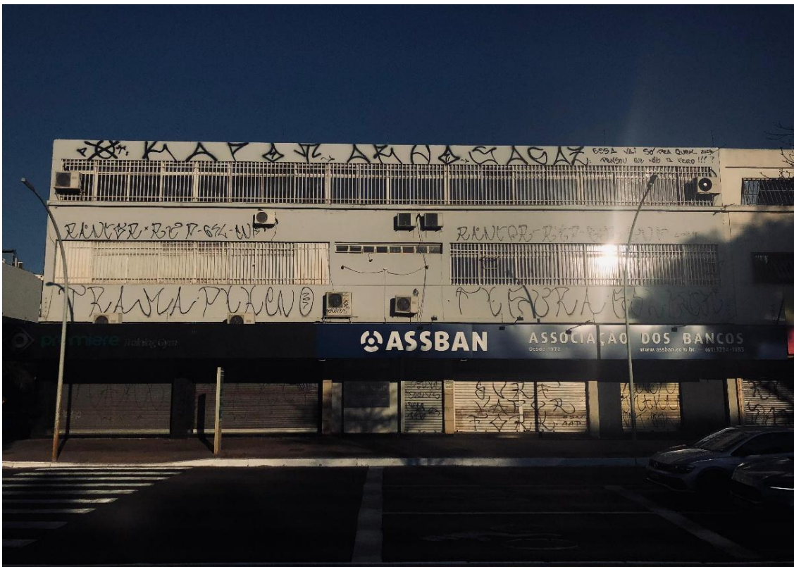
Edifício pixado na W3 Sul, em Brasília. / Fonte: Autora (2025).
